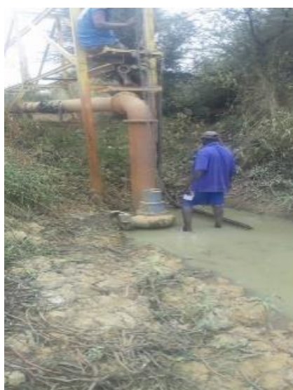
Figure 15 : Dénoyage de pompe dû à la baisse de l'eau dans la Ngalenka
