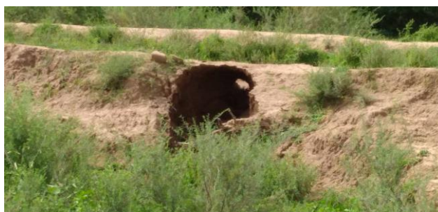
Figure 16 : Canal d'amenée dégradé et très enherbé à Nguidjilone
